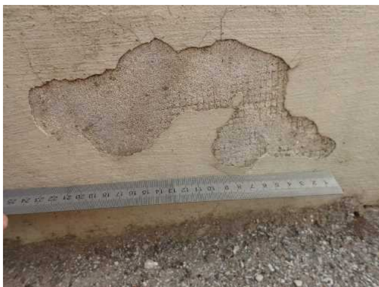
Loupání svrchní vrstvy omítky od výztužné mříže na povrchu ozdobného zábradlí v pásu těsně nad povrchem chodníku.
