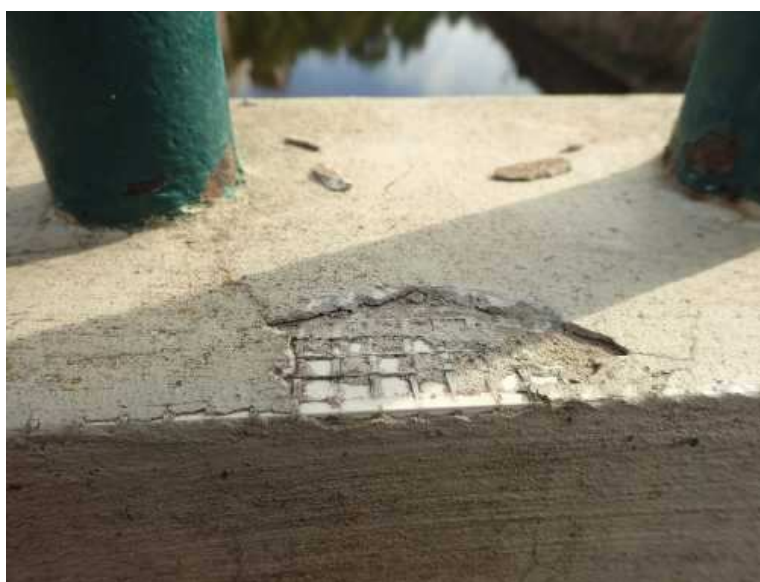
Loupání vyztužené omítky postupuje od hrany vylehčovacího otvoru ozdobného zábradlí.
