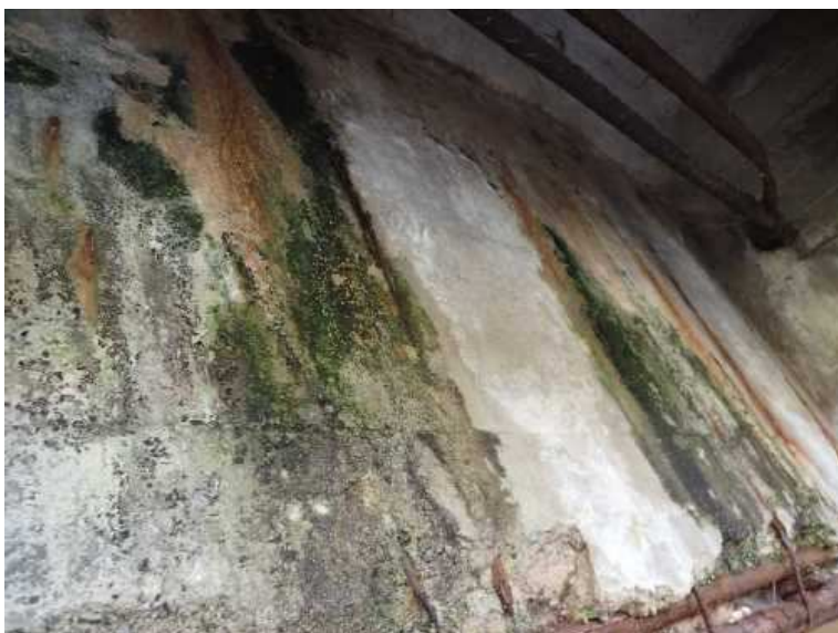
Vnější bok trámu 2P v úseku před opěrou O2, na který nejspíše desítky let prosakuje voda trhlinou ve styčném koutě s chodníkovou deskou.
