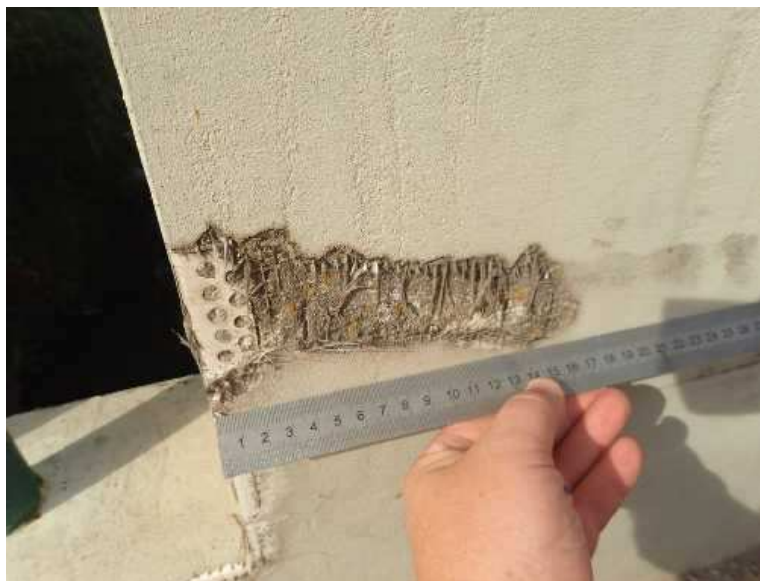
Mechanické poškození vyztužené omítky v líci ozdobného zábradlí zimní údržbou chodníků.
