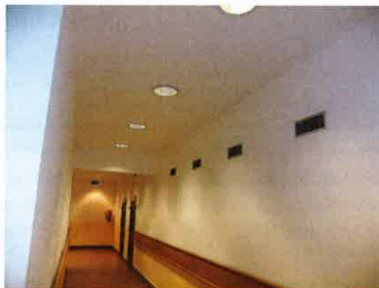
Chodba č.p. 8 nucené větrání
