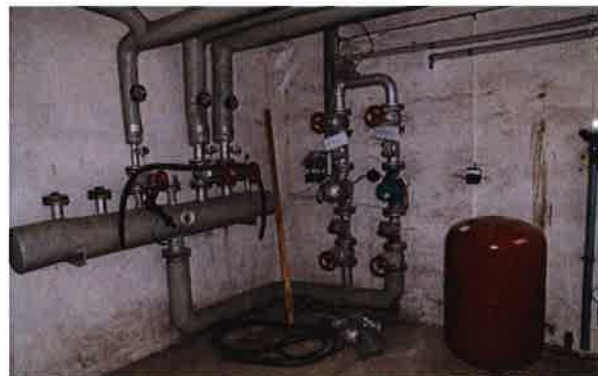
Plynová kotelna –čerpadla, sběrač
