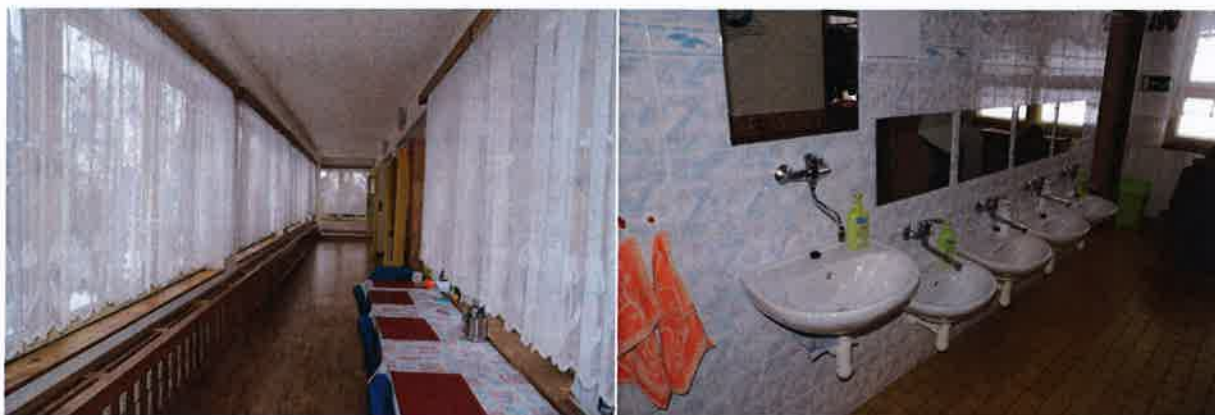
Chodba – tělesa bez TRV
