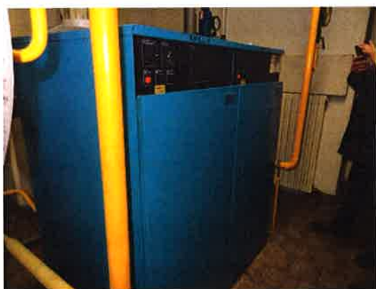
Plynová kotelna – kotle Hydroterm
