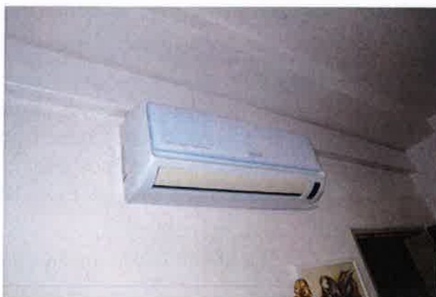
Kancelář–vnitřní jednotka TOSHIBA
