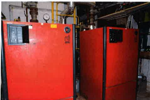
Plynová kotelna – kotle ORTAS
