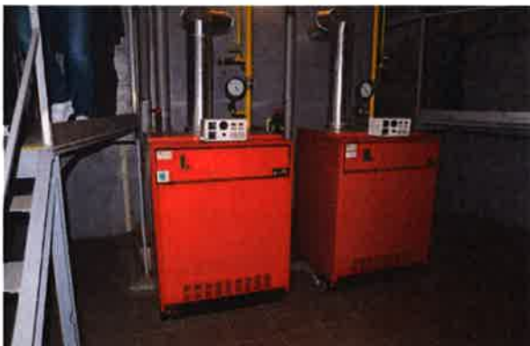
Plynová kotelna – kotle Viadrus
